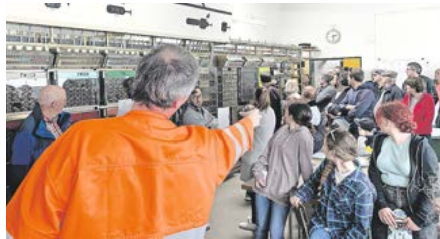
Albin Marty (orange Jacke) erklärte den Besuchern und Besucherinnen des SBB-Bahnhofes Arth-Goldau, wie das Stellwerk funktioniert. Bild: Jürg Auf der Maur
